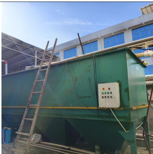
供销食品厂污水处理站沉淀池
