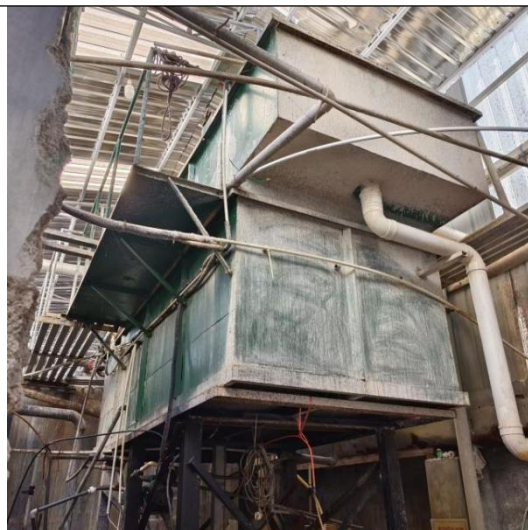
供销食品厂污水处理站厌氧池、好氧池
