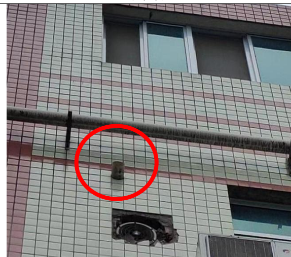
油烟排气管道
